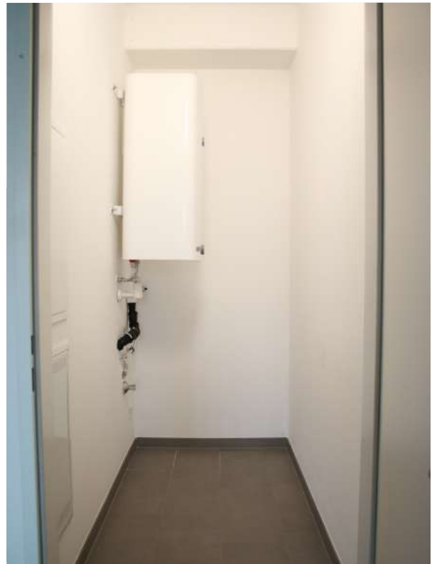
Abstellraum inkl. Boiler
