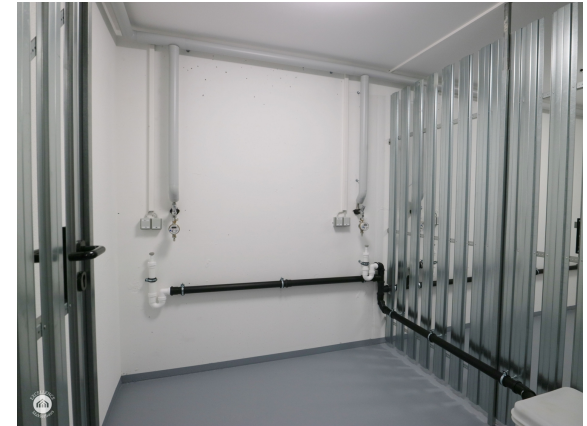
Waschmaschinenanschluss im Untergeschoss
