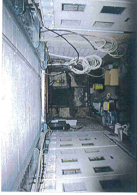
Zählerzentralisation im Keller ( Zusatzleistung )
