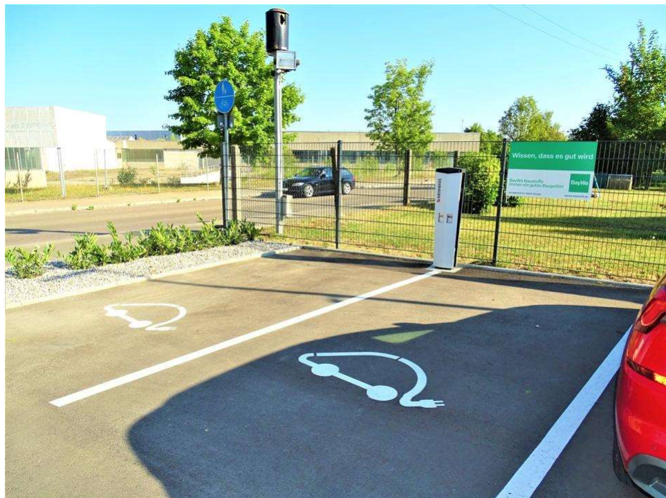
4 x Parkplätze mit E-Ladestationen
