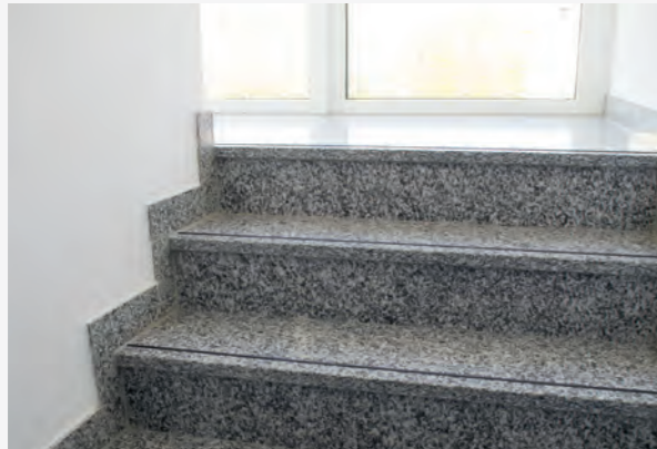
Treppenhäuser mit solidem Granit belegt – die eingelassene Gummilippe dient als Abrutschsicherung.
