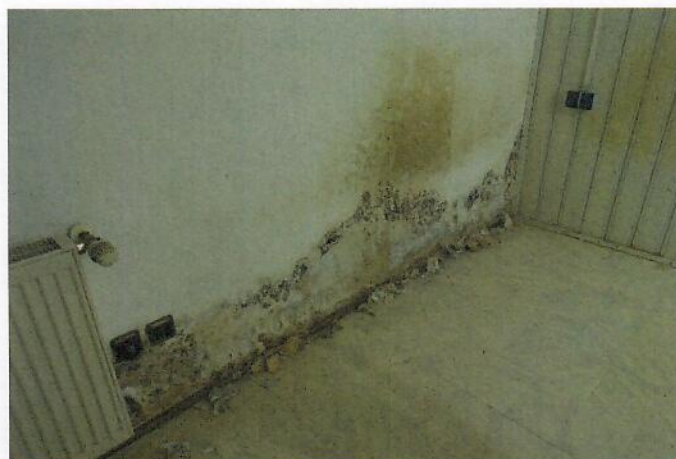
Wasserschaden in Kellerraum
