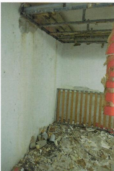
Schäden durch defekte Rohrleitung
