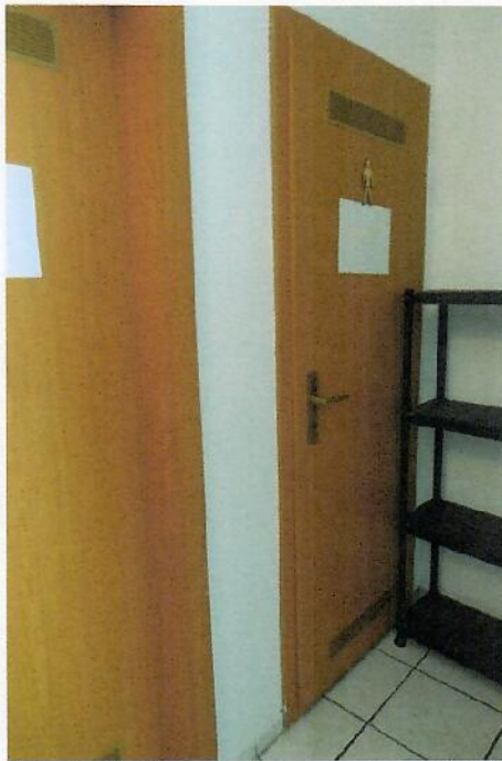
WC-Anlagen im EG (defekt)
