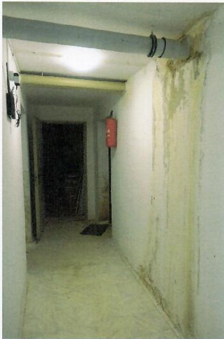
Wasserschaden im Kellergang
