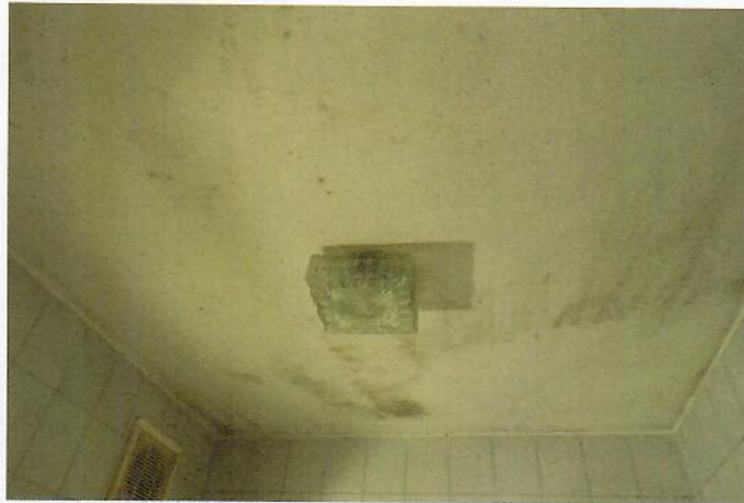
Schimmel an der Badezimmerdecke
