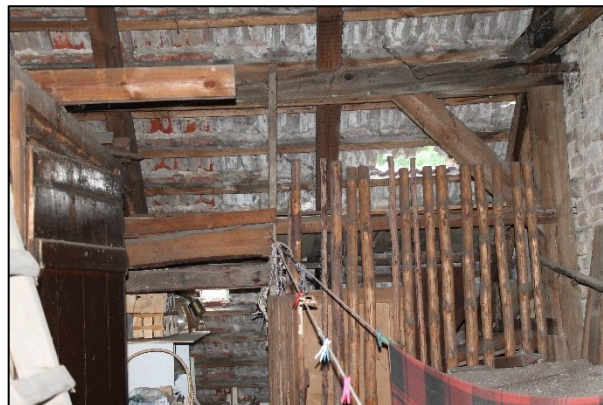
Defektes Dach, Reparatur erfolgt
