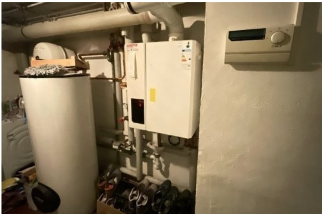
Gasbrennwert-Heizungsanlage mit Warmwasserkessel
