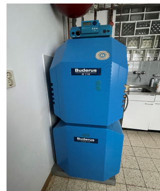
Zentralheizung mit Warmwasser
