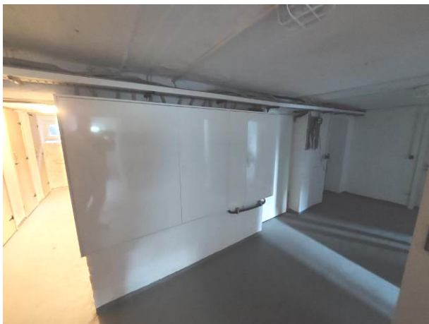
Kellergeschoss neue Elektroverteilung
