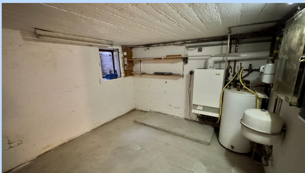
Kellerraum mit Heizungsanlage
