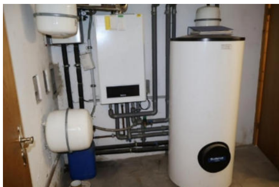
Abb. Heizungstechnik rechte Wohnung
