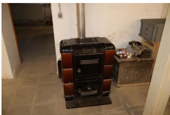
Abb. Kaminofen im Keller
