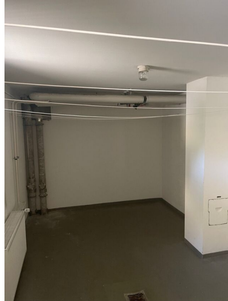
Trockenraum im Keller
