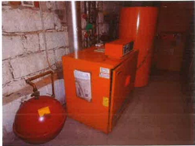
Heizungsanlage mit Warmwasserspeicher
