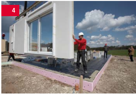
7:15 Uhr | Die ersten Climatic-Wände des Erdgeschosses werden bereits positioniert.
