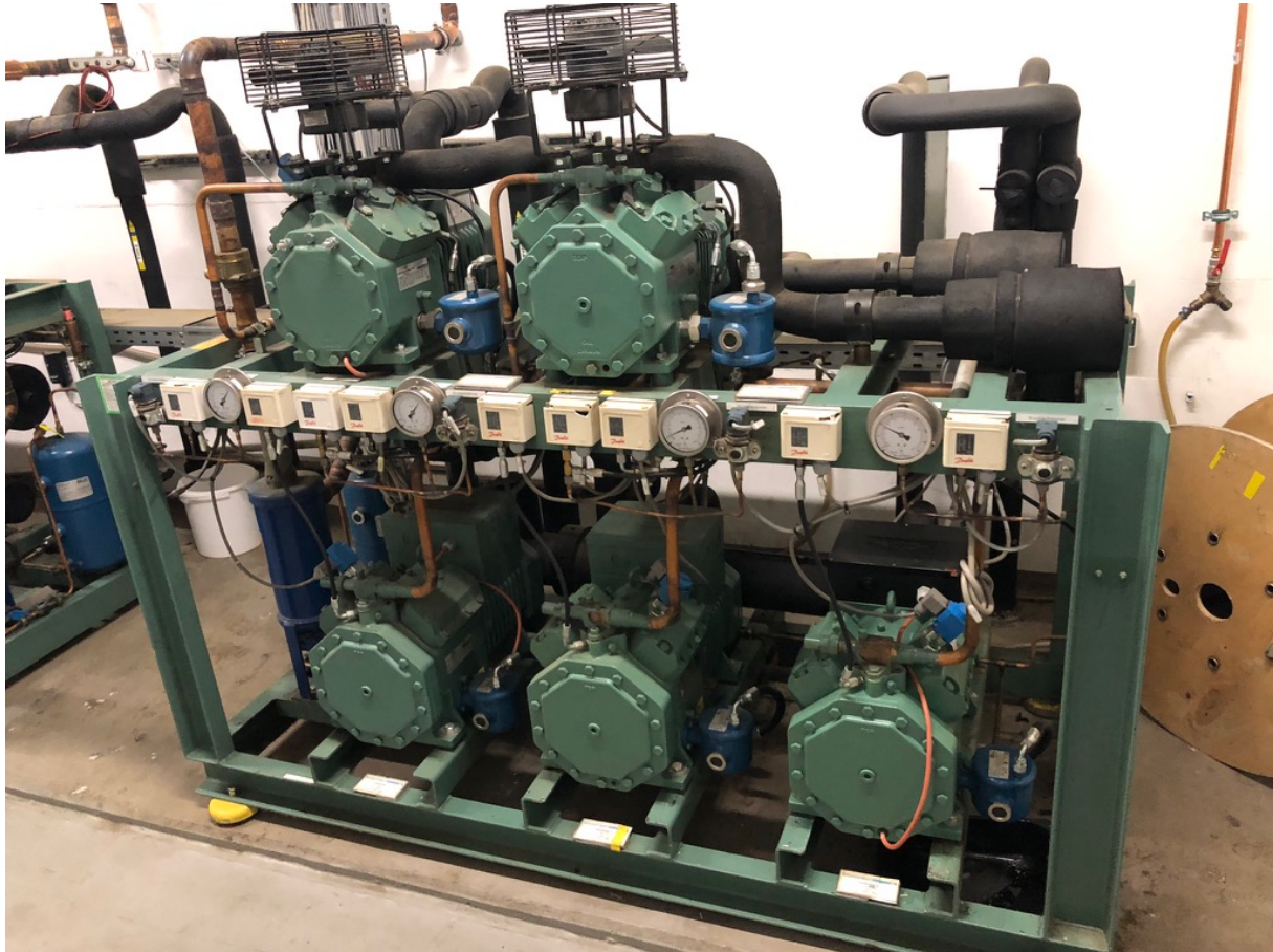
NK-Verbundanlage mit Kältemittel R449a
