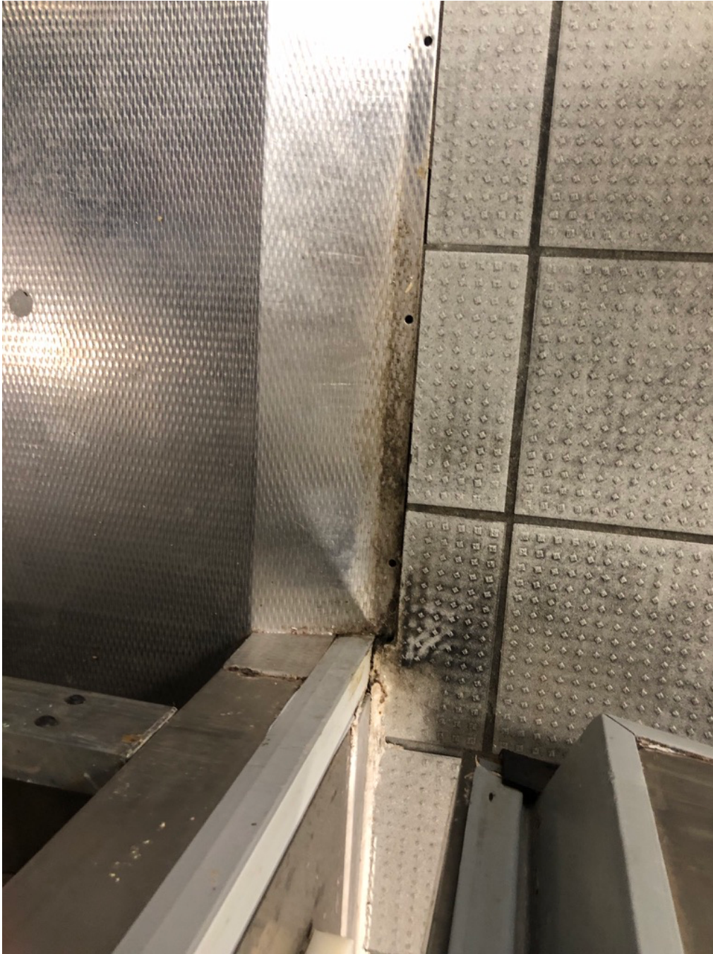
Bodenbelag im Schnellkühler
