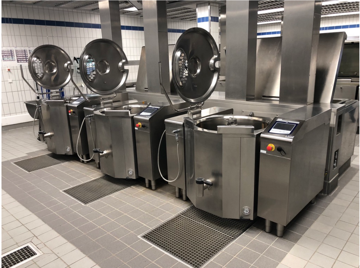
Rührwerkskochkessel mit Kühlfunktion, Einbau 2022
