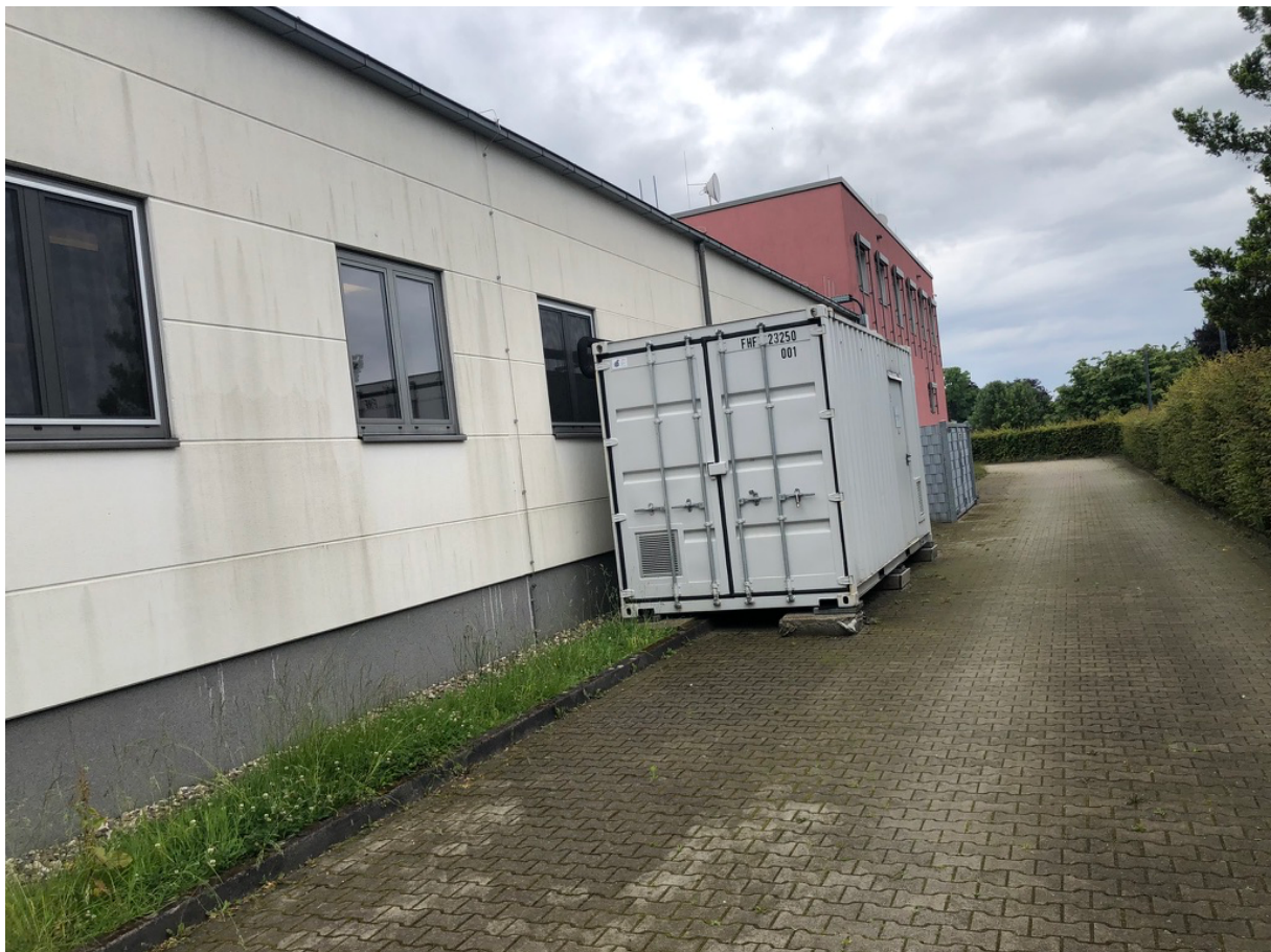
Container mit eingebauter Eisbank und CO 2 Kaskadenkühlung
