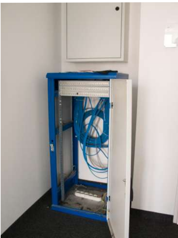
Serverschrank mit LAN-Anschlüsse
