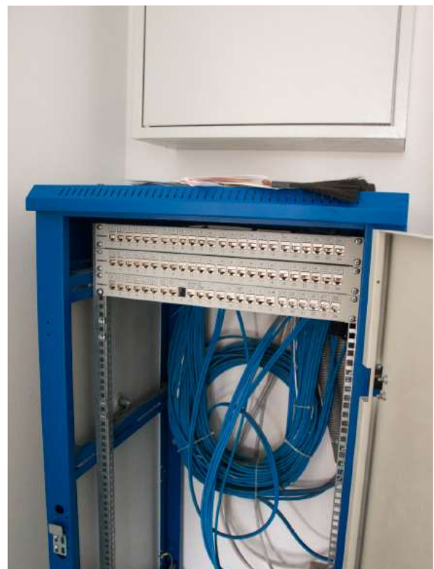
Serverschrank mit LAN-Anschlüsse
