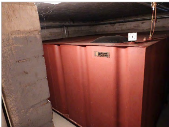
Heizöltank Keller Haus-Nr. 4
