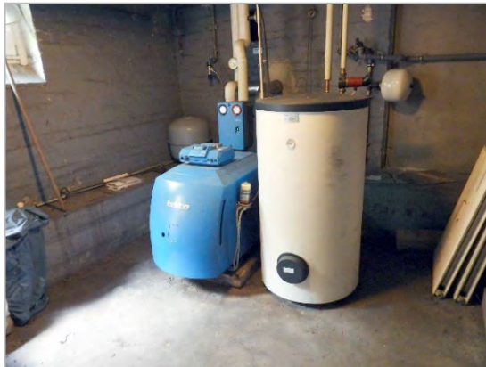
Heizung/Warmwasser Keller Haus-Nr. 4
