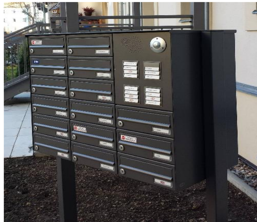
Briefkastenanlage mit Kameraeinheit V.V.K.-Objekt Braunsdorfer Straße 6
