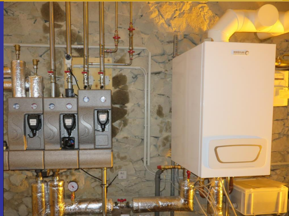
Heizungsanlage V.V.K.-Objekt Weinbergstraße 48/ 48a, Radebeul
