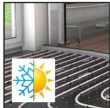
Fußbodenheizung mit Kühlfunktion
