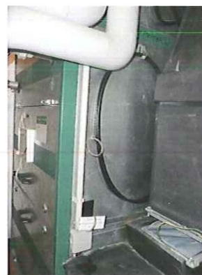
Abbildung 10 Lüftungsanlage Elektro Räume
