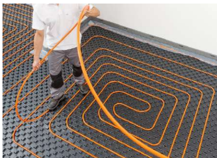
Suelo radiante hidráulico
