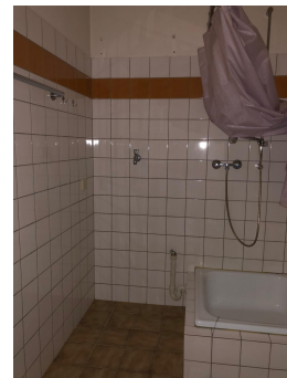
Badezimmer mit Waschmaschinenanschluss
