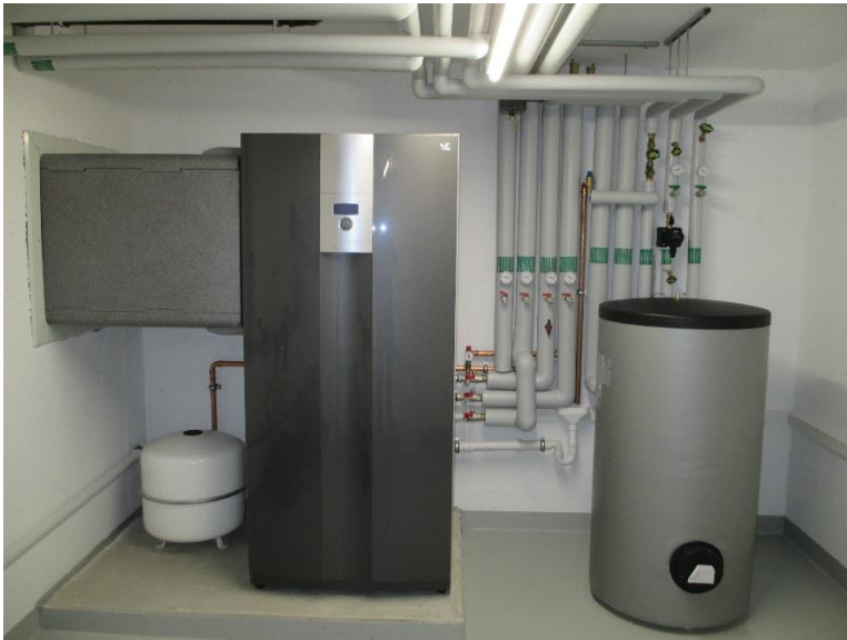
Heizung ohne Außeneinheit
