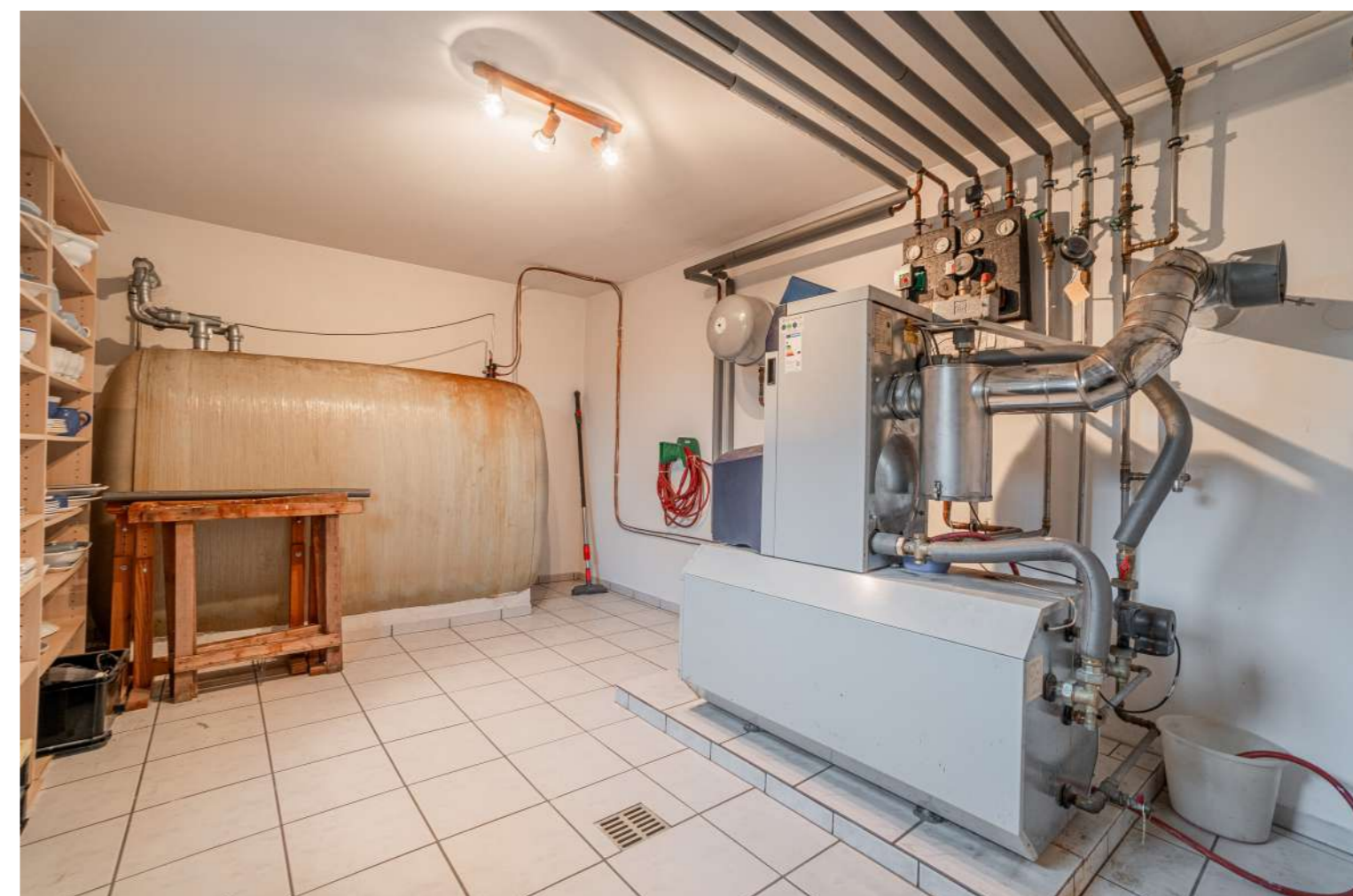
Technikraum im Keller, Ölzentralheizung (MAN-ECO Star 18 KW)
