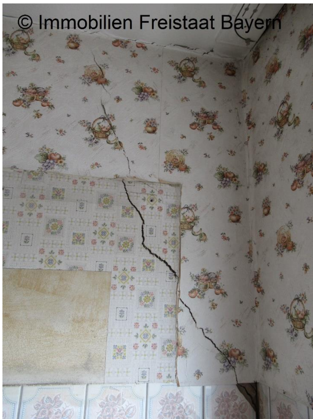
Rissbildung im Mauerwerk (Küche 1. OG)
