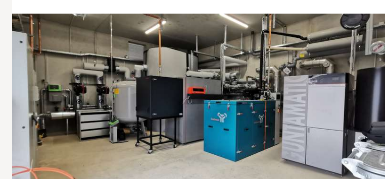
Im Innern der Energiezentrale.
