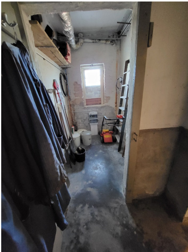
Geräteraum mit Pumpensteuerung
