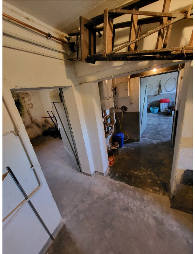
Kellerdurchgang zur Waschküche mit Gasbrennwerttherme
