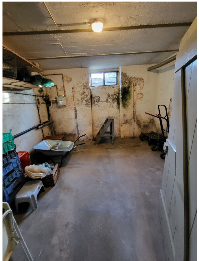
Vorratsraum 1 mit Hausanschluss für Gas
